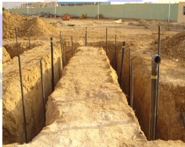
Fig.8 Emplacement des sondes tout au long de l'échangeur de chaleur.
