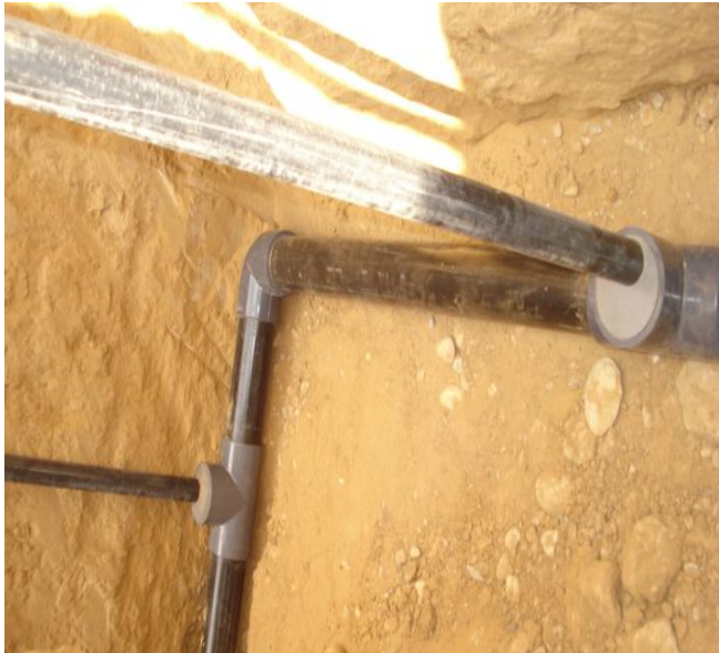
Fig.9 Emplacement détaillé des sondes de l'air à l'intérieur de la gaine.
